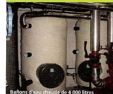
Ballons d'eau chaude de 4 000 litres
