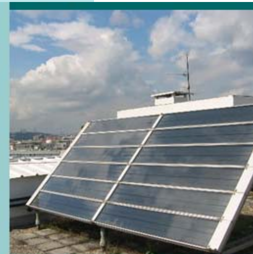
Capteurs solaires thermiques actifs depuis 25 ans. Résidence "Le Bernin" Lyon 8ème
