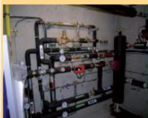
Panneau hydraulique du bâtiment A.
