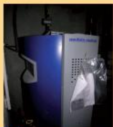
Chaudière gaz à condensation
