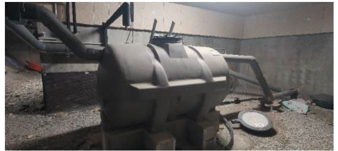
Figure 40 : Photographie du vide sanitaire spacieux, de la cuve de récupération, ainsi que l'échelle donnant accès au trou d'homme situé en partie supérieure de la cuve
