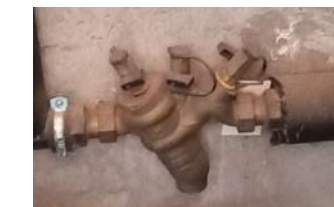
Figure 26 Disconnecteur de type BA
