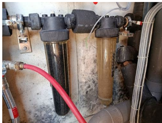
Figure 71 : Dispositifs de filtration en aval de la cuve. Le filtre de maille de 90 µm est à droite, le filtre à charbon à gauche
