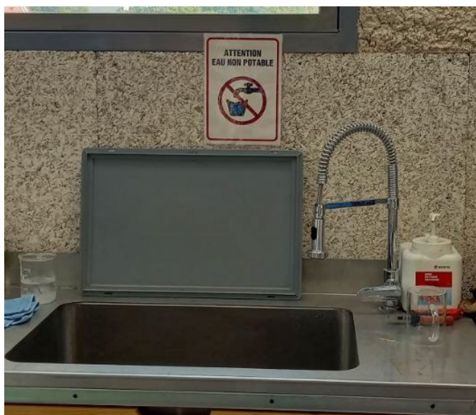
Figure 61 : Signalétique aux points d'eau des ateliers
