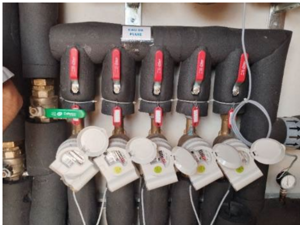
Figure 72 : Photographie des compteurs d'alimentation en eau de pluie des quatre logements collectifs et de la
