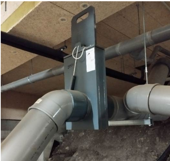
Figure 43 : Photographie de la vanne à guillotine en amont de la cuve et de la canalisation de détournement, visible à droite
