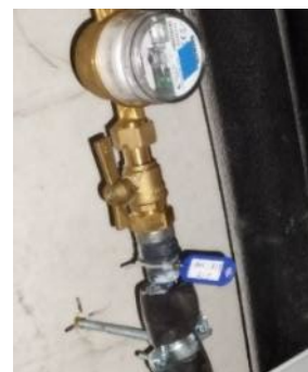
Figure 34 : compteur d'eau de pluie pour 3 logements.
