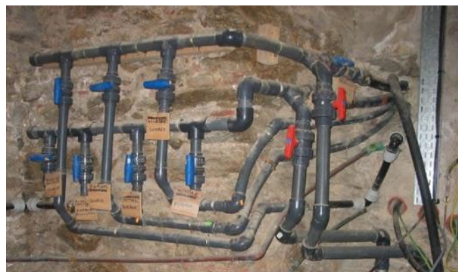
Figure 76 : Photo de 3 usages alimentés à la fois par l'eau du forage (potable) et par l'eau du bassin. Le choix de l'alimentation se fait par action des vannes. Image appartenant à la MOA.
