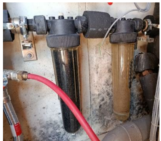
Figure 21 Installation couplant un filtre à cartouche de 90 µm de maille de filtration (à droite) et un filtre à charbon actif (à gauche) avec défaut d'entretien
