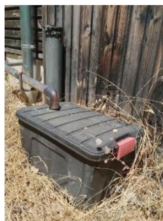
Figure 91 : caisse de filtration des eaux grises issues des lave-linges communs contenant de la paille compressée
