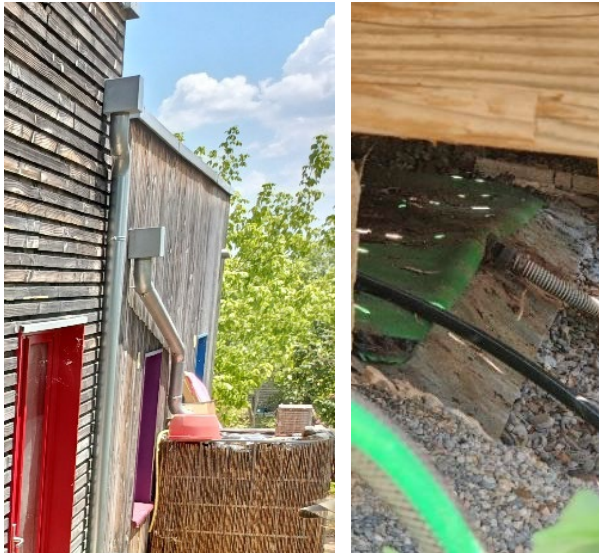
Figure 88 : Boîtes à eau et des descentes d'eau pluviale (gauche) Réseaux (droite) : arrosage (tuyau souple en premier plan) apport cuve (tube noir au second plan) alimentation en sortie de cuve (tube canelé gris)
