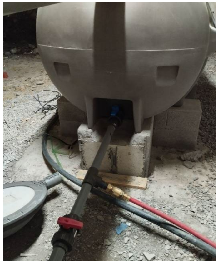
Figure 44 : Photographie du tuyau de relevage de la cuve de récupération en partie basse de celle-ci, en rouge à droite
