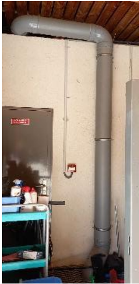
Figure 80 Photographie de la canalisation PVC unique récupérant les descentes d'eau de pluie pour alimenter la cuve
