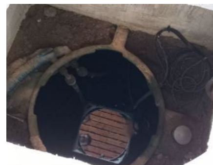
Figure 82 Photographie d'un des deux regards de la cuve enterrée, ouverte, avec les tuyaux d'arrivée d'eau et de relevage
