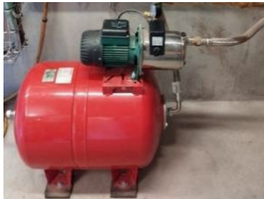
Figure 46 Photographie du dispositif de pompage et surpression composé de la pompe centrifugeuse et du réservoir à diaphragme
