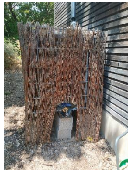
Figure 90 : Une des cuves rigides récupérées à un industriel local, recouverte de canisses.
