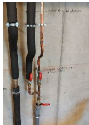
Figure 41 Photographie du réseau d'alimentation des sanitaires et de l'arrosage et de la vidange, en bas à droite
