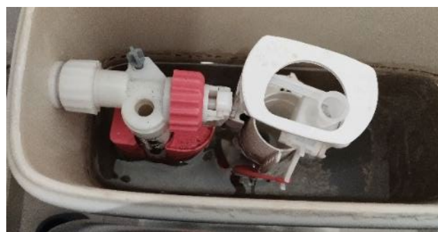
Figure 36 : eau de pluie stockée dans le réservoir des sanitaires, illustrant un déficit de filtration
