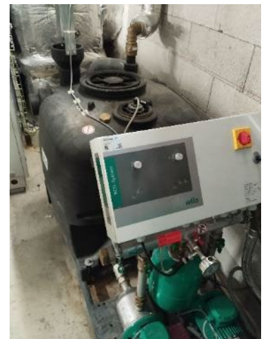
Figure 56 : gestionnaire pour la récupération des EP
