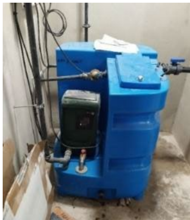
Figure 33 : système gestionnaire des eaux de pluie dans le local technique R-1 du bâtiment A
