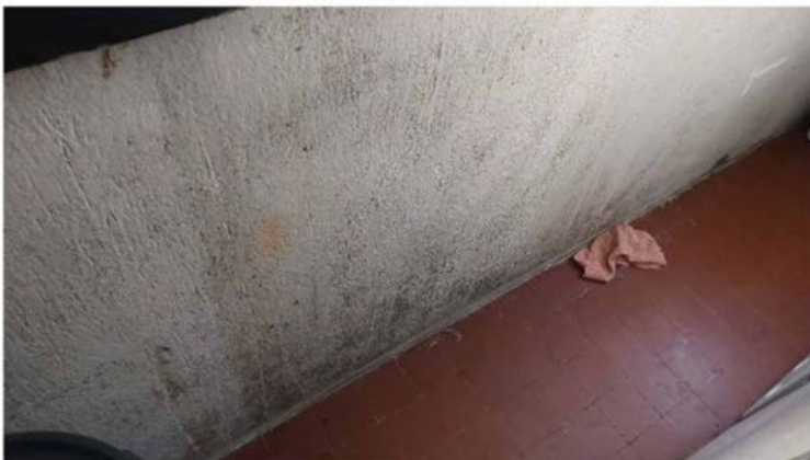
Séchoir sans isolation thermique, apparition de moisissures
