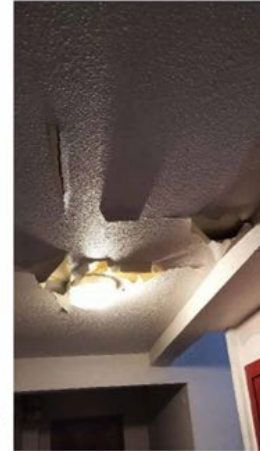
Peinture craquelée au plafond
