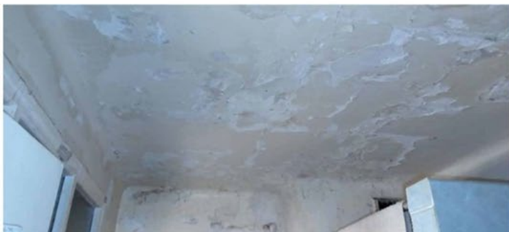
Plafond SDB détérioré
