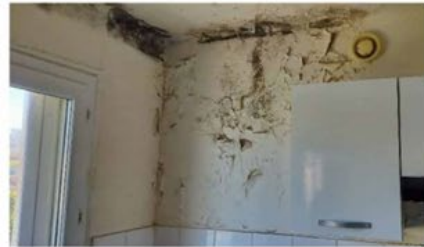
Ventilation insuffisante des cuisines
