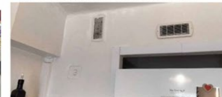
Ventilations des cuisines F2
