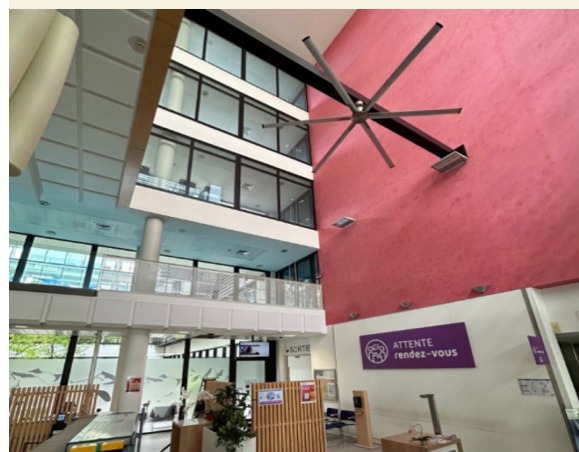
CPAM_brasseur : Mise en place de brasseurs à pales dans le hall d'accueil du siège de la CPAM à Annecy
