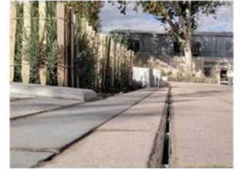
Récupération discrète des EP
