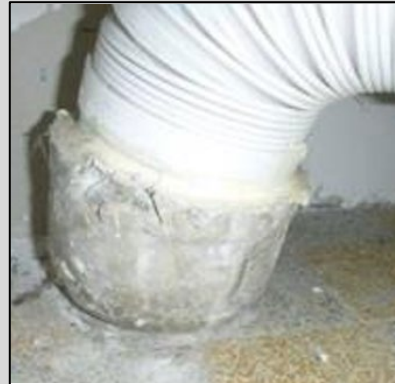
Conduit en fibres-ciment
