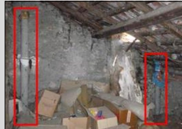
Conduits en fibres-ciment
