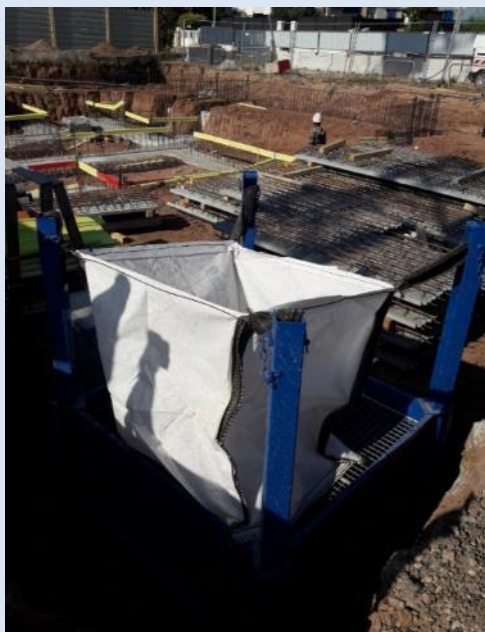
Zone décantation des eaux béton
