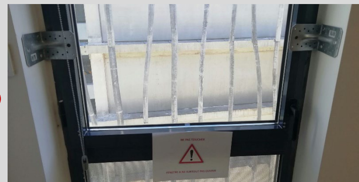
Fenêtre condamnée - locaux d'ENEDIS
