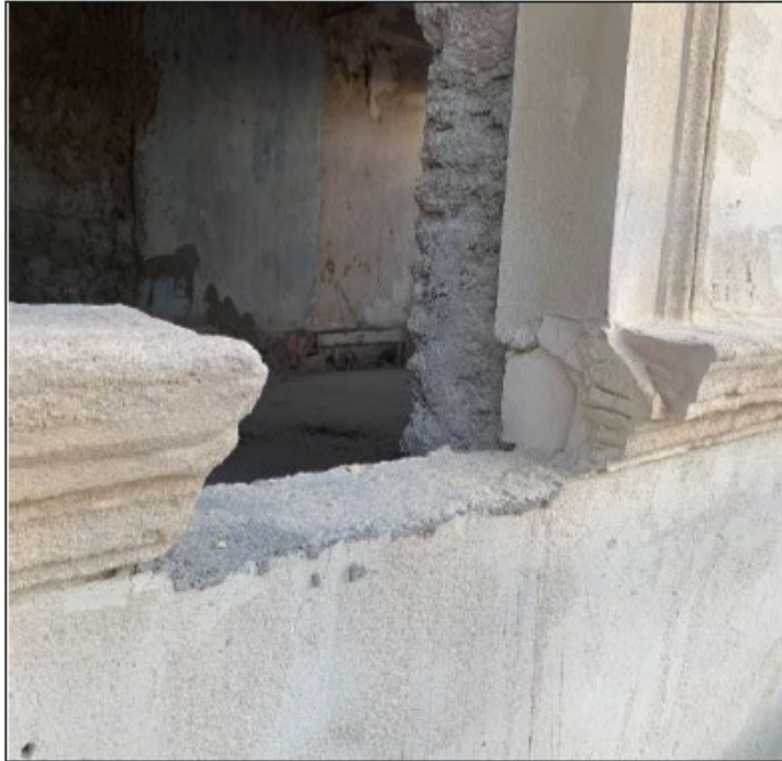
Appui de fenêtre déposé
