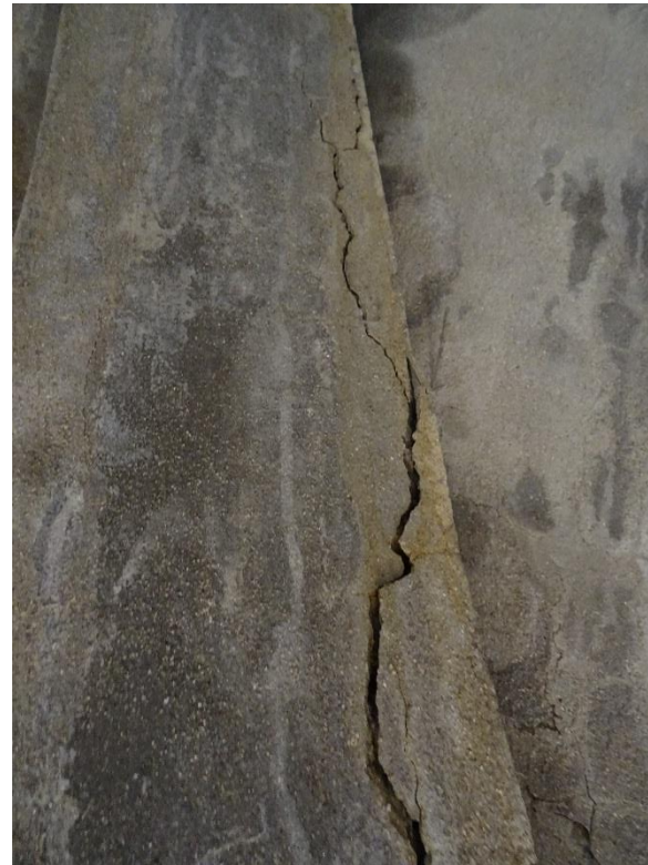
Fissure et efflorescence sur le béton
