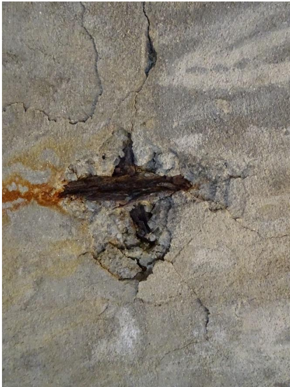
Eclatement de la maçonnerie à l'intérieur de la coupole et corrosion feuilletante du fer
