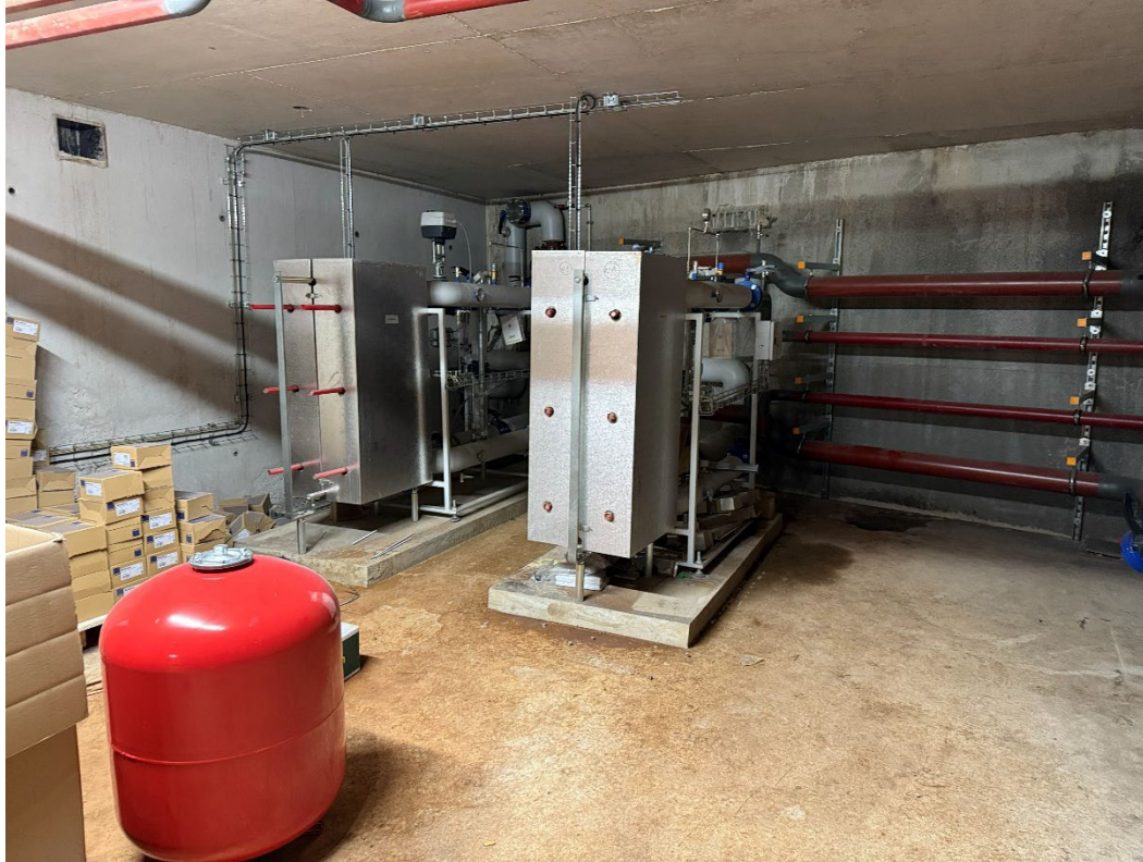
Reseau de Chaleur Urbain Thassalia
