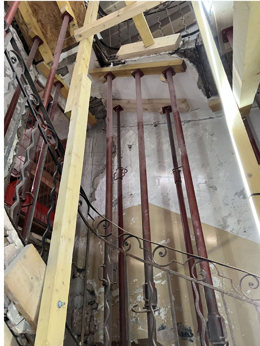
Photo escalier sécurisé - MS4
