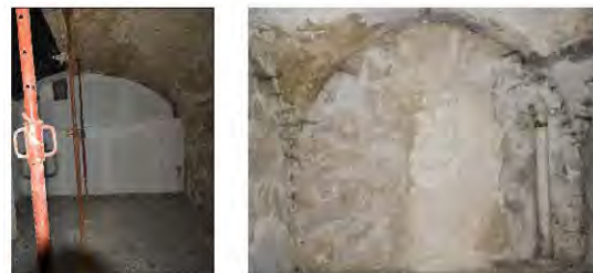
Détails des caves dans les immeubles de la rue Jean Roque. Voutains en pierres sans refends supplémentaires, voutains en briques (remaniement) du XIXème siècle
