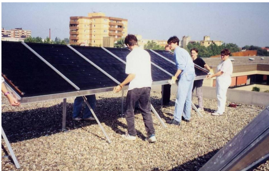
Figure 10: Installation de panneaux solaires sur le toit de l'école (source : www.energieagentur-avh.de )
